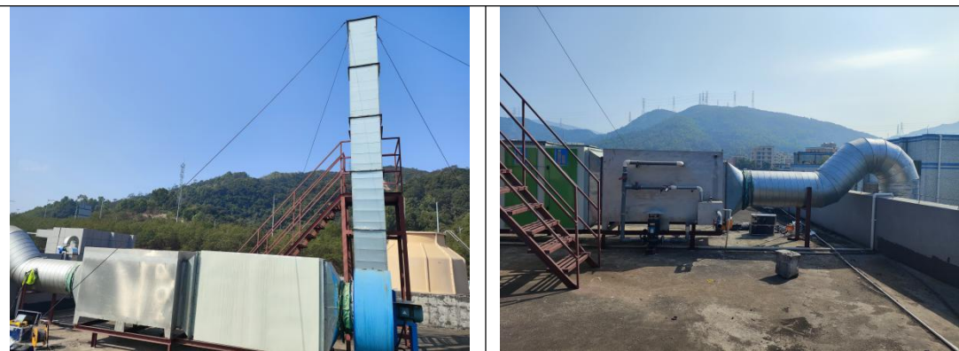
废气处理设施
