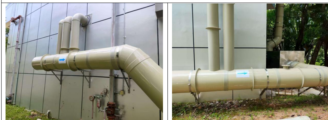
废气收集管道走向
